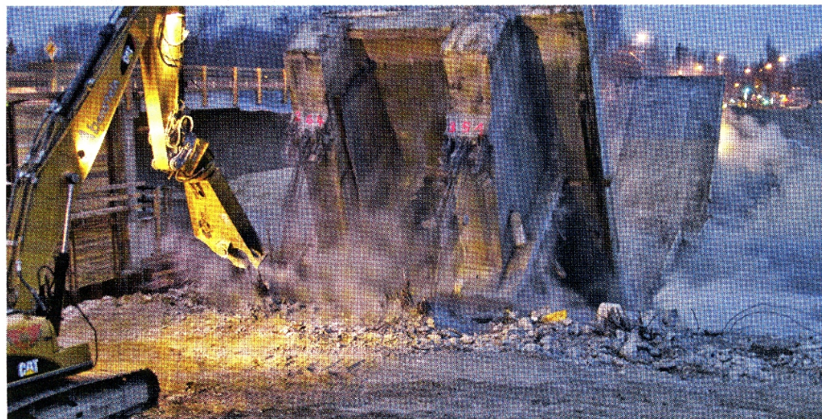
Die Brücke stürzt zusammen.
